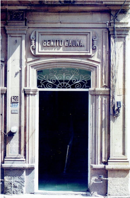
FOTOGRAFÍA 14. Acceso lateral que conduce a la planta alta independiente del inmueble, detalle de jambas, dintel y pilastras de cantería
