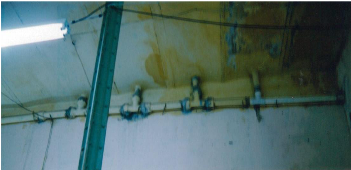
FOTOGRAFIA. 37. Instalación sanitaria en malas condiciones.
