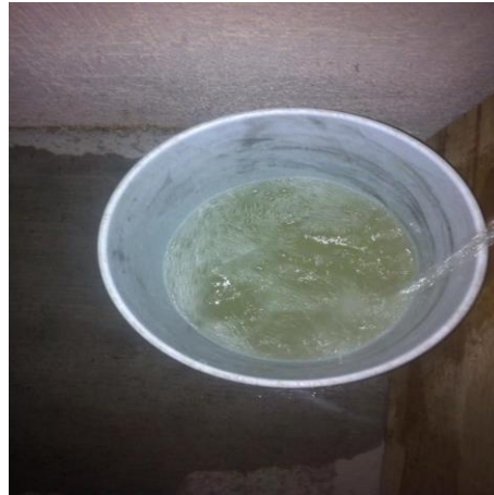
IMAGEN 10: Captación de agua de lluvia.
