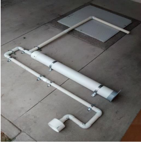
IMAGEN 2: Vista antes de instalar.
