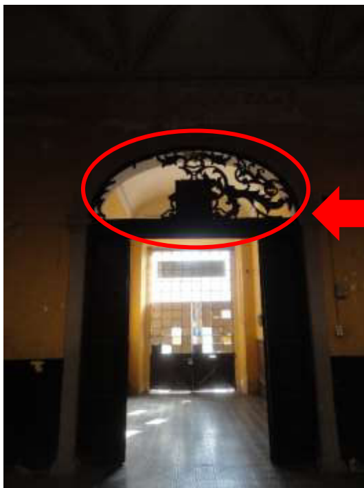
Deterioro de puertas, falta de molduras.
