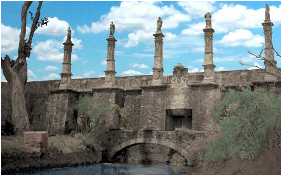
Ilustración 9 Estado de conservación de la presa de los Santos. s/a
